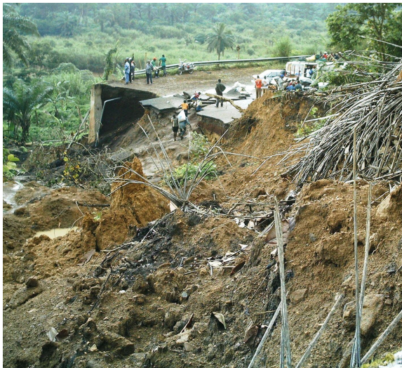
Figure 5. Route effondrée après le glissement de terrain à Kekem.
